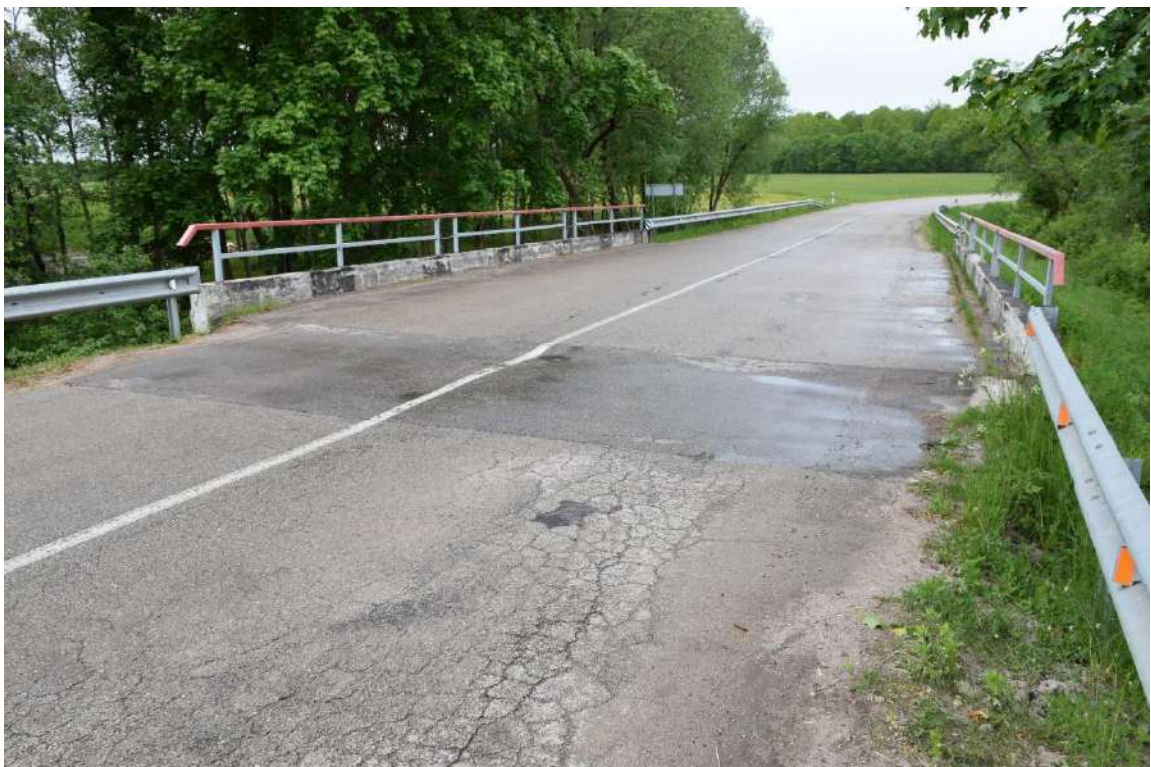
9 pav. Kelio sujungimas su tiltu nusėdęs, susiformavęs laiptas. Matosi, kad laiptas susiformavęs ne pirmą kartą – prasėdusi vieta buvo perasfaltuota siekiant išlyginti prieš tai buvusį prasėdimą. Galima priežastis – netinkamai arba visai neįrengtos pereinamosios plokštės
