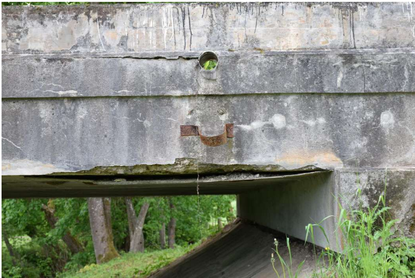
12 pav. Sulūžęs vandens nuvedimo latakas
