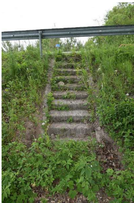
13 pav. Laiptų pakopos apaugusios žolėmis, patekimas ant laiptų viršuje užtvertas apsauginiu atitvaru, turėklų nėra
