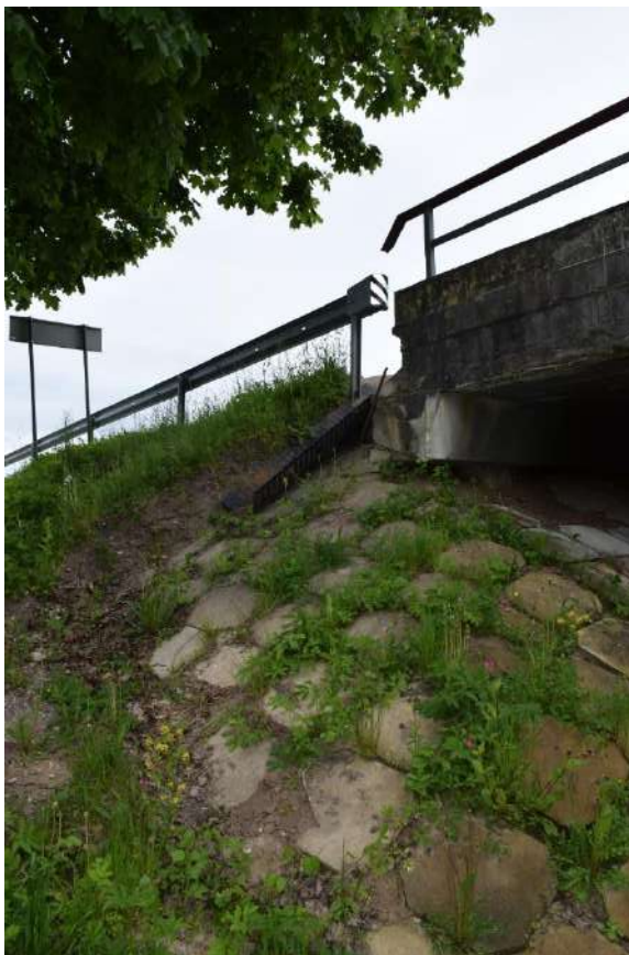
10 pav. Dėl nuolatinės nepriežiūros pro šlaito tvirtinimo plytelių tarpus auga žolė
