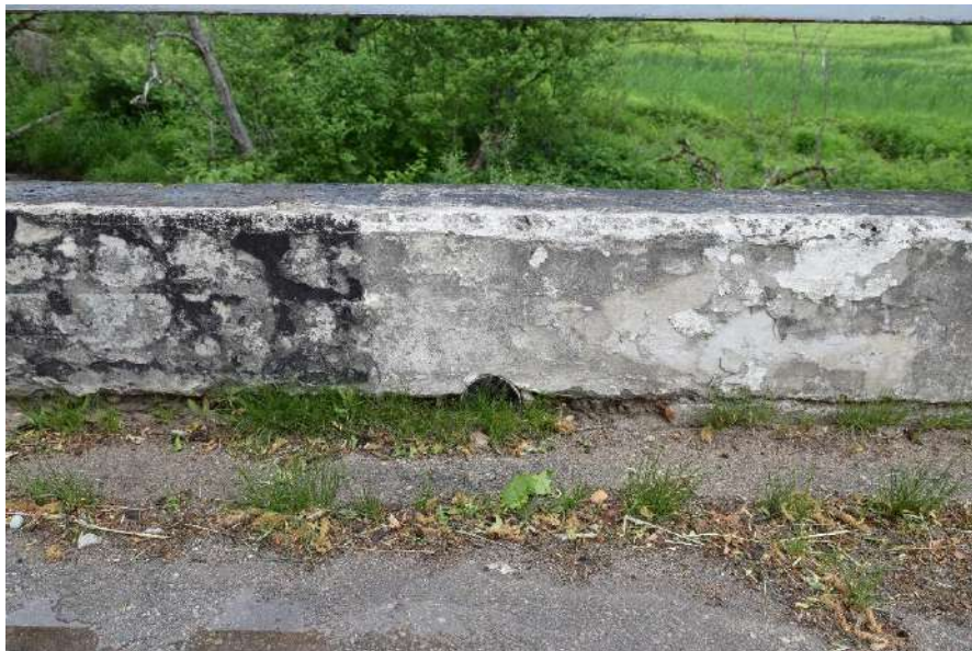
5 pav. Dėl nuolatinės nepriežiūros suneštame purvo sluoksnyje auga žolė
